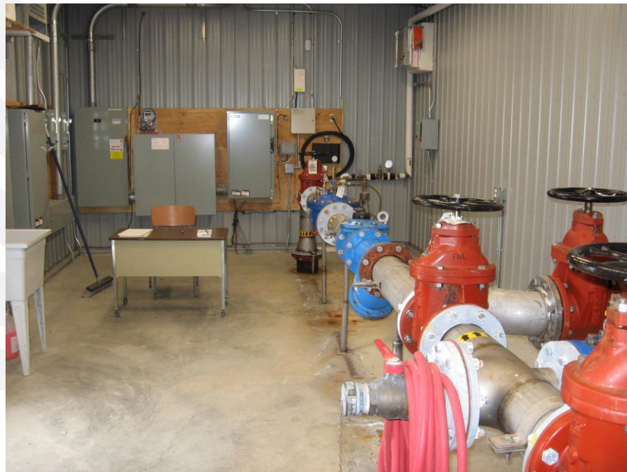
Vue de la salle de mécanique du puits Bélisle 1
